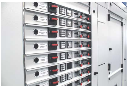
Réalisation Ste Kautz Starkstrom-Anlagen GmbH (Allemagne)
