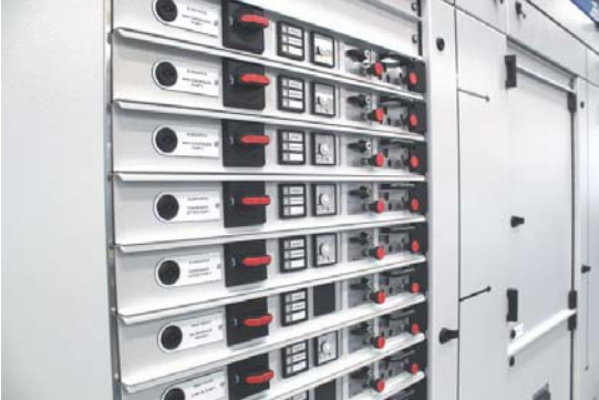
Realización Compañía Kautz Starkstrom-Anlagen GmbH (Alemania)
